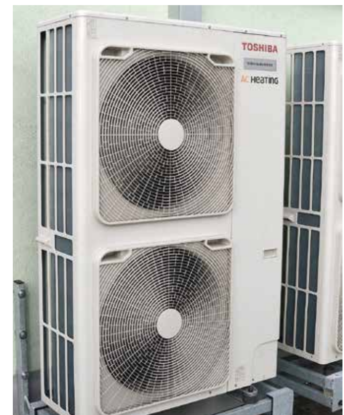
Tepelná čerpadla lze umístit i na střeše panelového domu.
