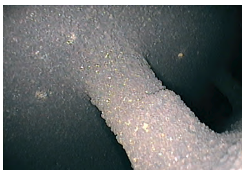
Spoj článků radiátoru před čištěním
