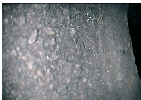
Stěna radiátoru před čištěním
