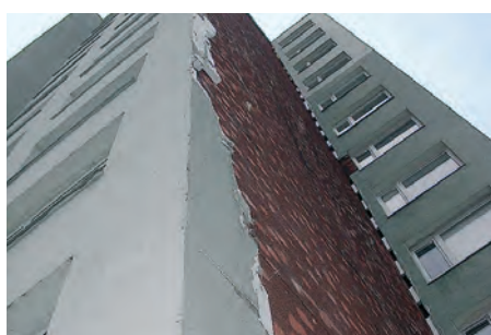
Obr.: Důsledky neřešení ztráty stability zateplovacího systému
