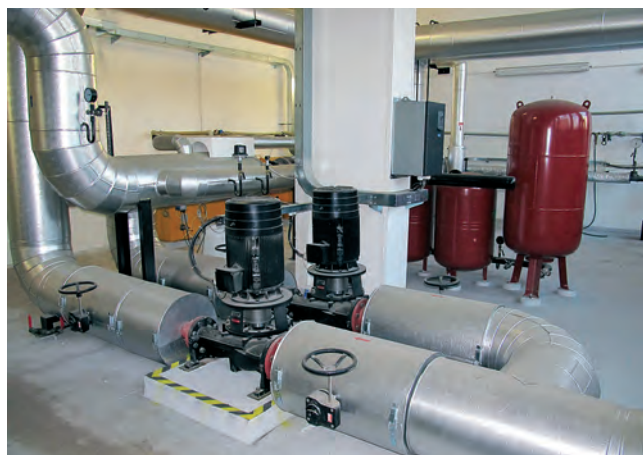
Plynové kotelný nahradily v Bílině předávací stanice.
