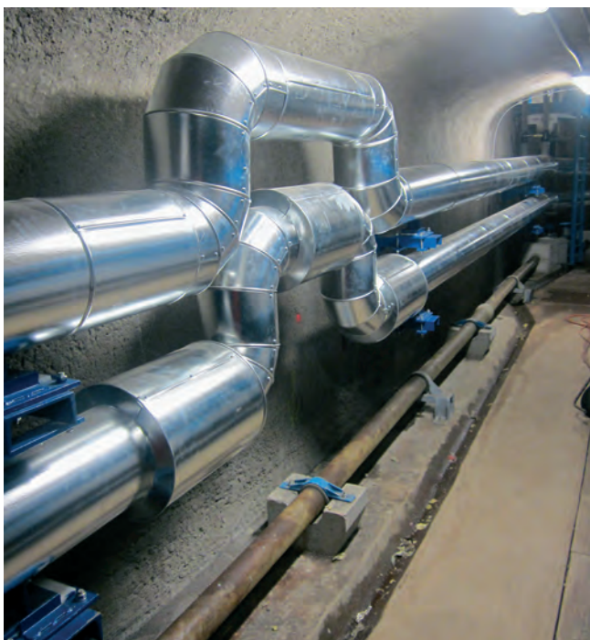
Brněnské horkovody vedené v podzemních kolektorech.
