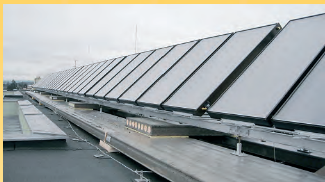
Kolektorové pole z kolektorů Suntime 2.1 na panelovém domě v Rakovníku
