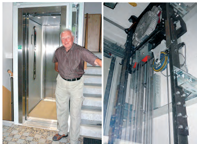
Moderní výtah a jeho strojovna
