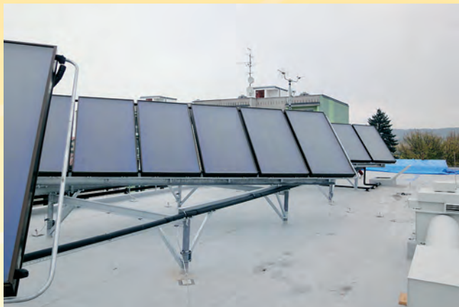
Kolektorové pole z kolektorů Suntime 2.1 na panelovém domě v Dobrušce
