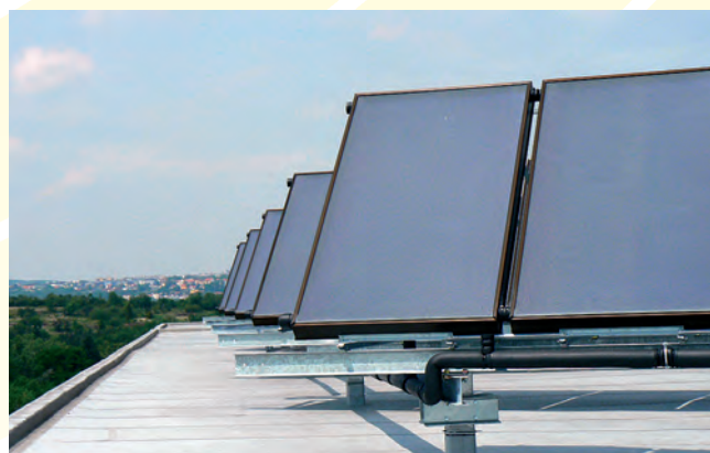
Kolektorové pole z kolektorů Suntime 2.1 na bytovně v Praze
