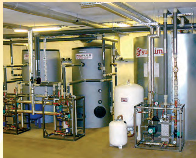
Technologie ohřevu teplé vody solárním systémem Suntime pro ubytovnu v Praze, výměňkové stanice a akumulční zásobníky o celkovém objemu 7 000 l, dohřev pomocí CZT
