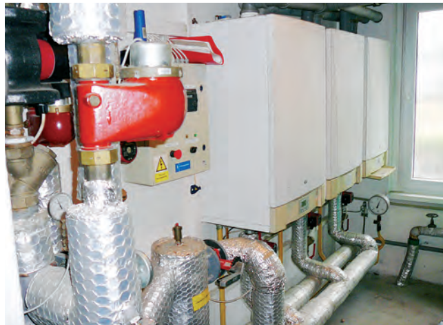
Kaskáda plynových kotlů BAXI
