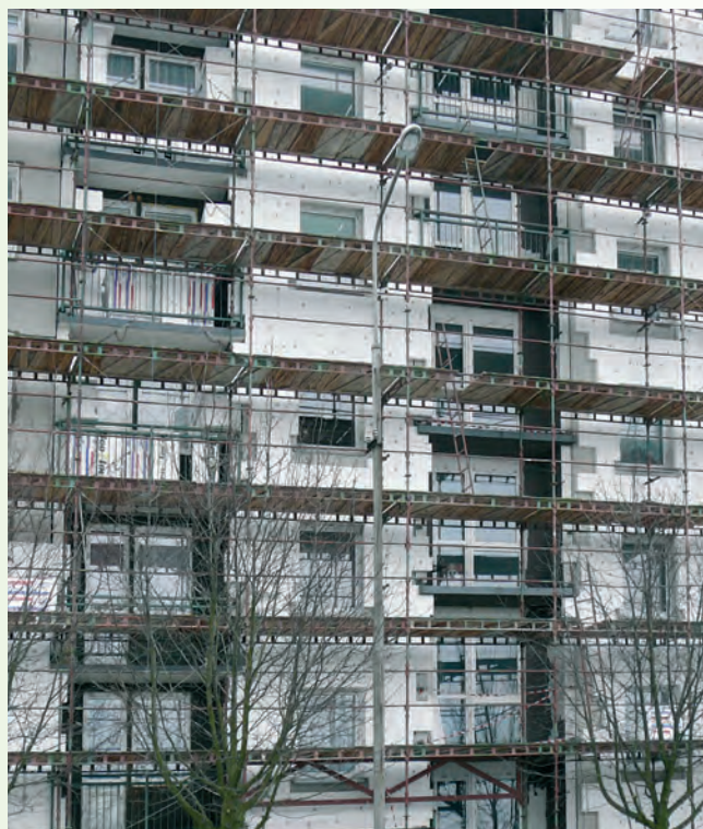
Můžeme postupně provádět dílčí opravy domu.
